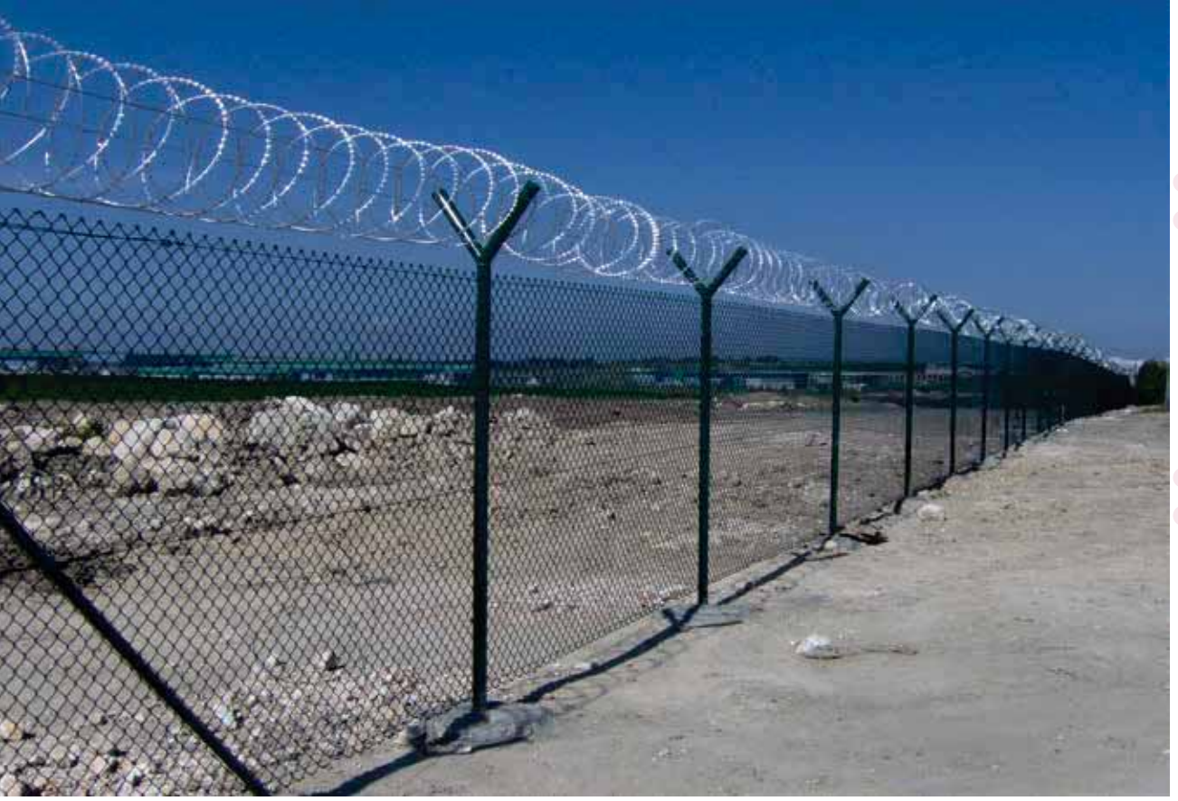
Galvaniz üzeri PVC kaplı örgü tel uygulaması ve helezon jiletli tel uygulaması, polyester kaplı direk ve payandalar. Galvanized & PVC coated chainlink fence & razor wire concertina application - polyester coated post & braces.
