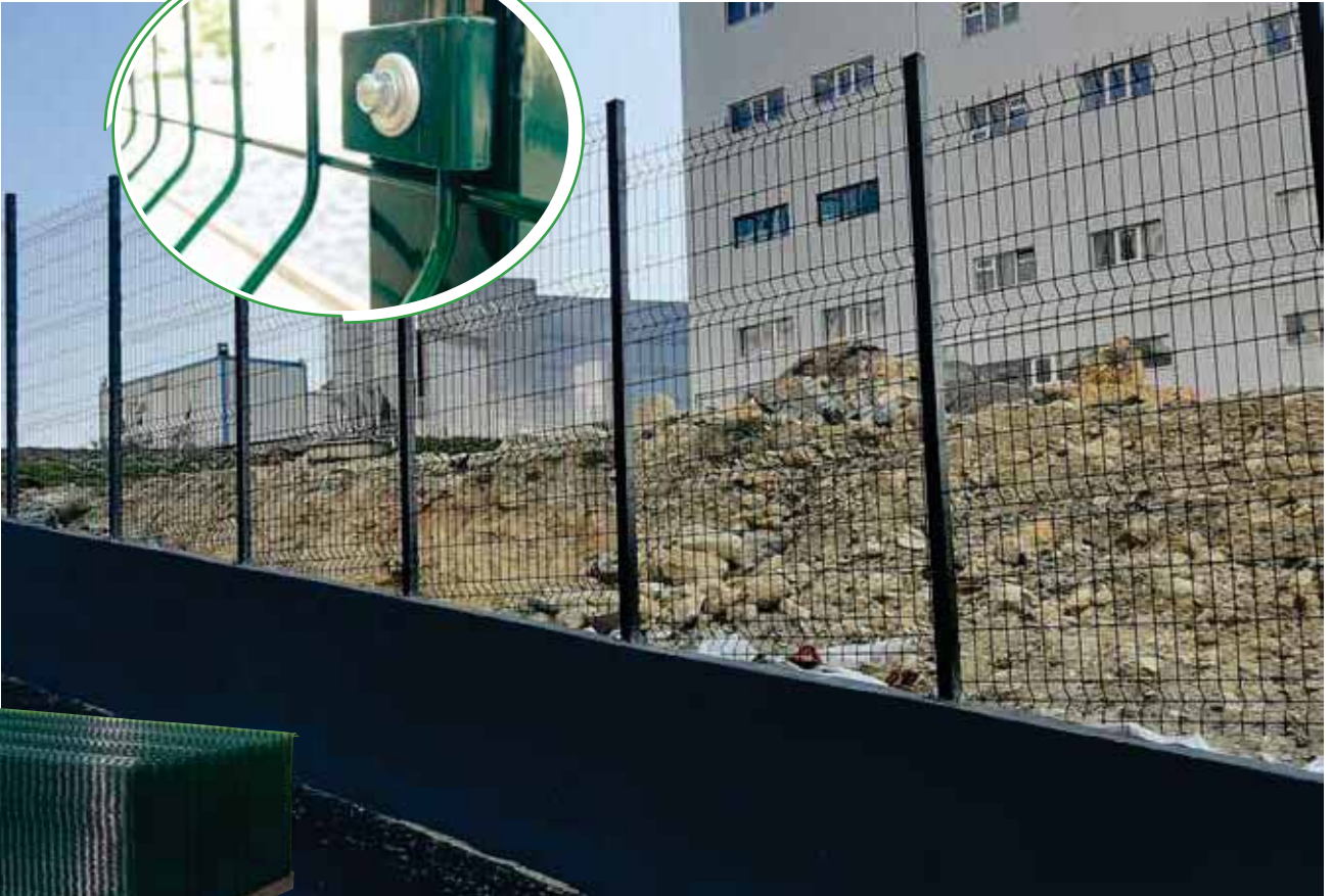
Metal klips ile panel çit uygulaması. Panelfence installation is made by metal clips.
